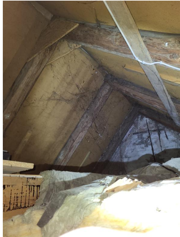
Figur 2.15: Bygning 5, loftrummet med tydlige spindelvæv
